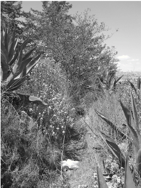
IMAGEN 6. Vegetación en muro de contención, Calixtlahuaca, Toluca
