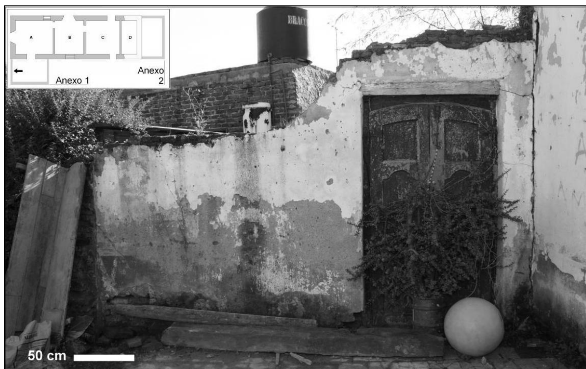
Figura 12. Vista de la única pared en pie del anexo 1
