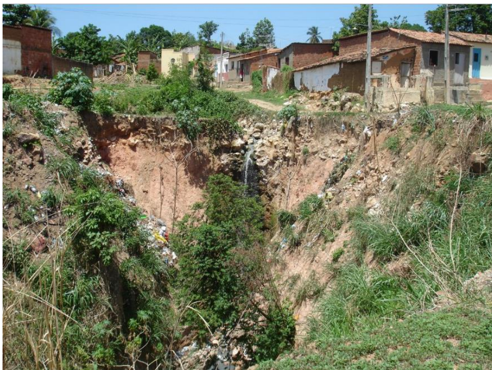
Figura 1 - “Vulcão” antes da obra. Fonte: < https://blogdoqrato2.wordpress.com/2007/01/18/a-cratera-do-crato/ > (Acesso em: 26 dez. 2016)
