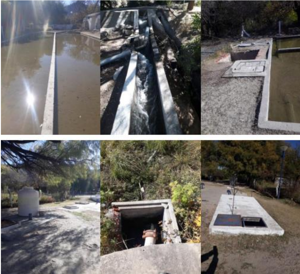
Planta potabilizadora de Chumbicha - Catamarca
