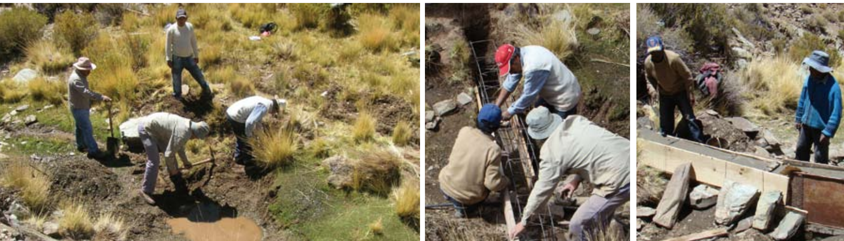
Limpieza del sitio y construcción del muro. Urcuro. San Antonio de los Cobres. Salta
