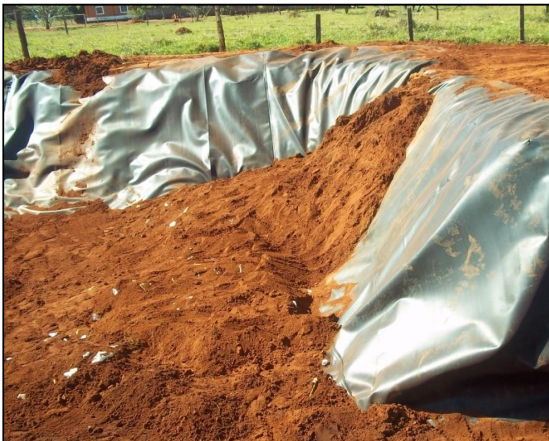
Figura 2: Vala séptica para resíduos de serviços de saúde Fonte: arquivo próprio
