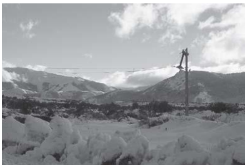
Poste de luz quebrado en la nevada del 2007
