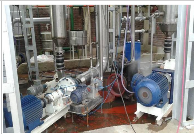
Figura 5: Bombas del evaporador Fuente Rubio y Asociados
