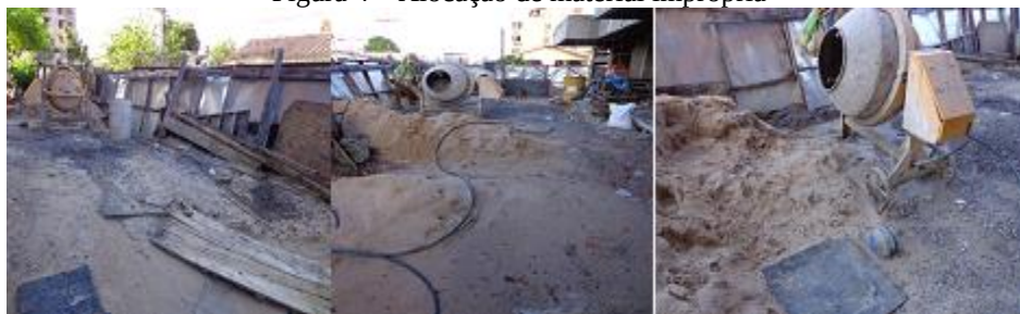
Figura 4 – Alocação de material imprópria
