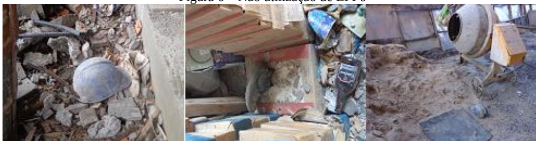
Figura 6 – Não utilização de EPI's
