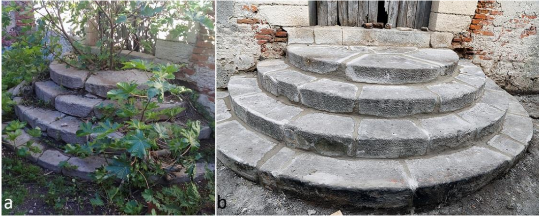
Figura 20. a) Estado previo a la intervención en la escalinata principal de acceso, año 2016; b) restauración en 2020. Fuente: Archivo de los autores.
