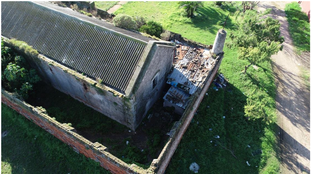
Figura 19. Construcción precaria ubicada en el espacio del corredor perimetral. Año 2019. Fuente: Archivo del Municipio A.
