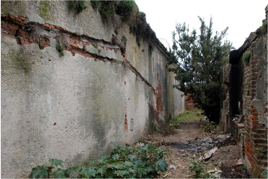
Figura 15. Cortes de la mampostería, invasión de vegetación y deterioros en cornisa en muro del edificio. Año 2016. Fuente: Archivo de los autores.
