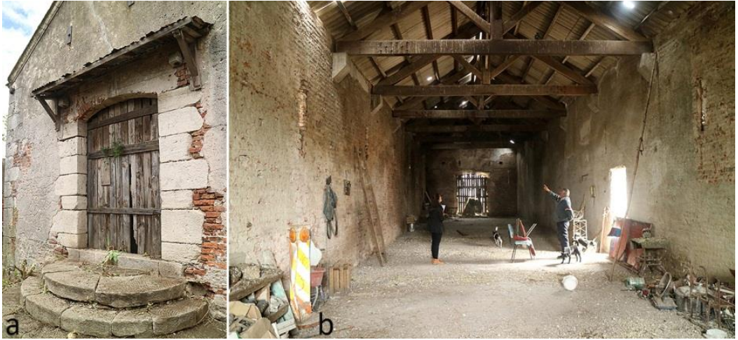
Figura 10. Imágenes de reconocimiento de estado de la edificación del año 2016; a : entrada principal al edificio; b : interior. Fuente: Archivo de los autores.
