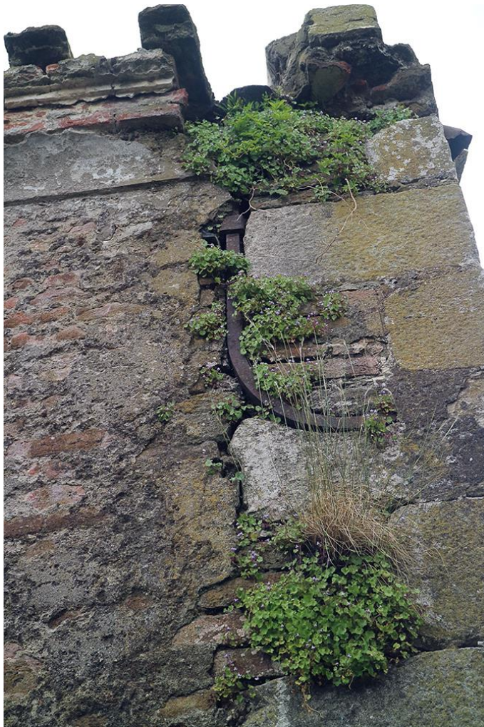
Figura 16. Detalle de separación en esquinas entre sillares de piedras y mampostería. Año 2016. Fuente: Archivo de los autores.
