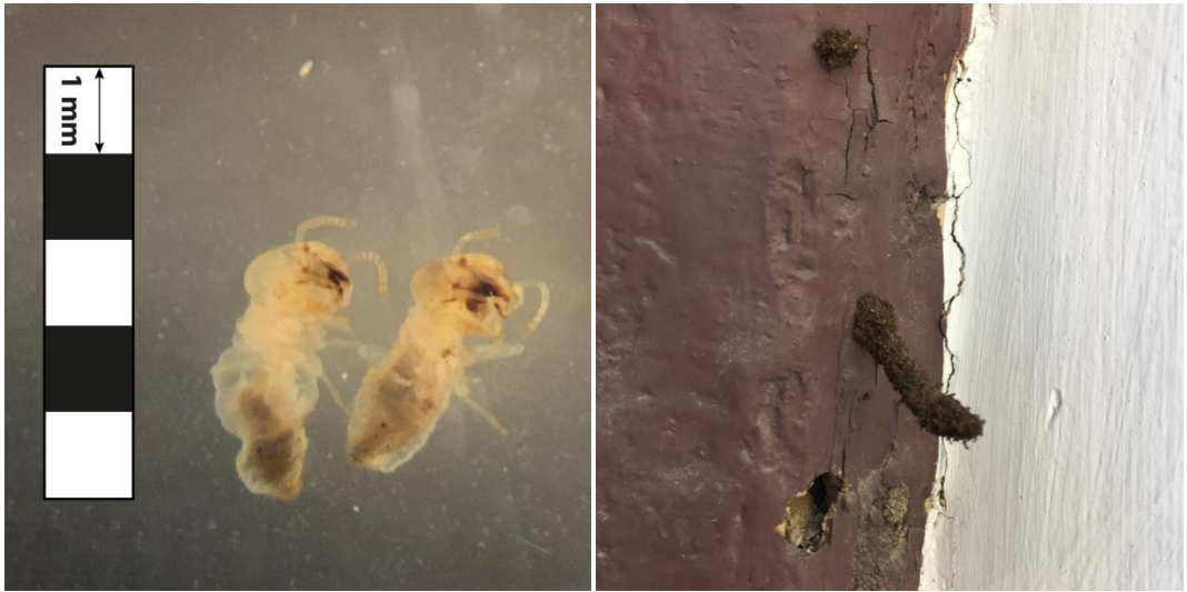
Figura 1 (izq.) – Dos ejemplares de termitas obreras recuperadas del techo del edificio. Figura 2 (der.) – Un tubo de alimentación construido por las termitas sobre las carpinterías (Fotografías R. Mariani)
