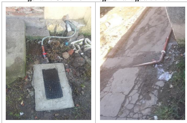
Figura 4: Conexión irregular al agua de red
