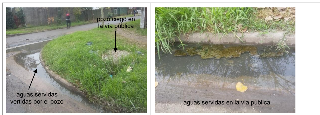
Figura 3. Aguas servidas en la vía pública vertidas desde viviendas con pozos ciegos llenos
